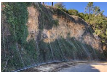
Redes de Proteção
