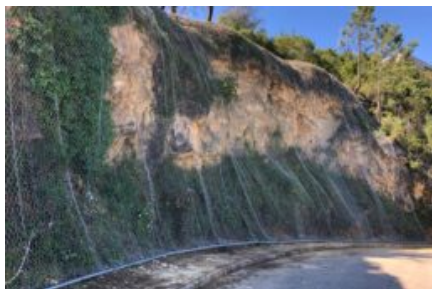
Redes de Proteção
