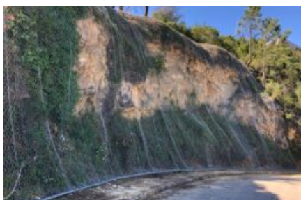
Redes de Proteção
