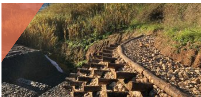
Estabilização de solos e bacias de dissipação hidráulica no Vale da Ameixoeira
