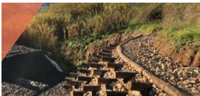
Estabilização de solos e bacias de dissipação hidráulica no Vale da Ameixoeira
