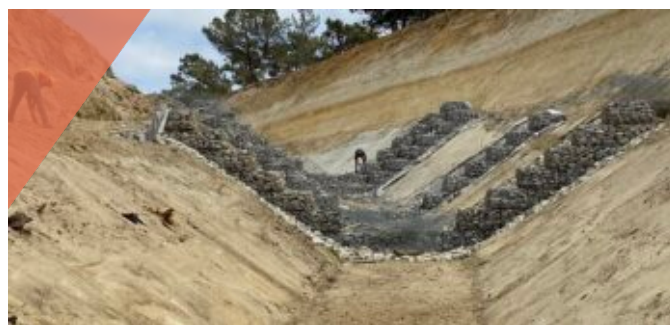
Dissipadores de carga hidráulica em Gabiões
