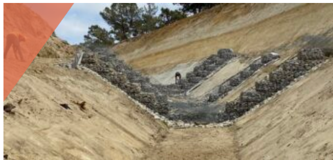
Dissipadores de carga hidráulica em Gabiões
